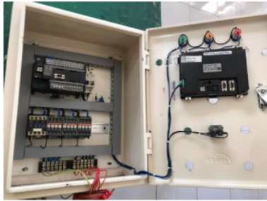
Gambar 5. Wiring Sistem Kontrol Mesin Pengupas Kelapa Muda Berbasis PLC
