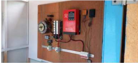
Gambar 7. Instalasi Kontrol PLTS dan PLTB
